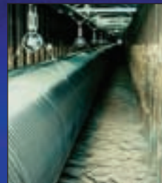
Um Störungen durch Luftdruckschwankungen auszuschließen, verläuft der Laserstrahl in einem evakuierten Rohr. Die 600 m langen Vakuumrohre sind in einem Graben aufgehängt.
